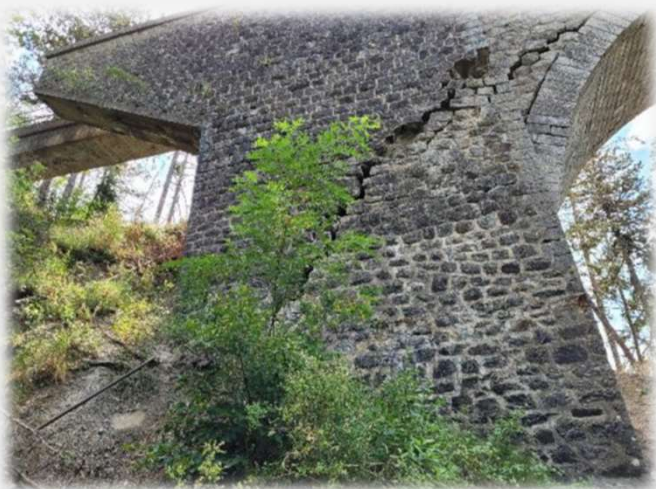
Fracture décimétrique d'une pile-culée
